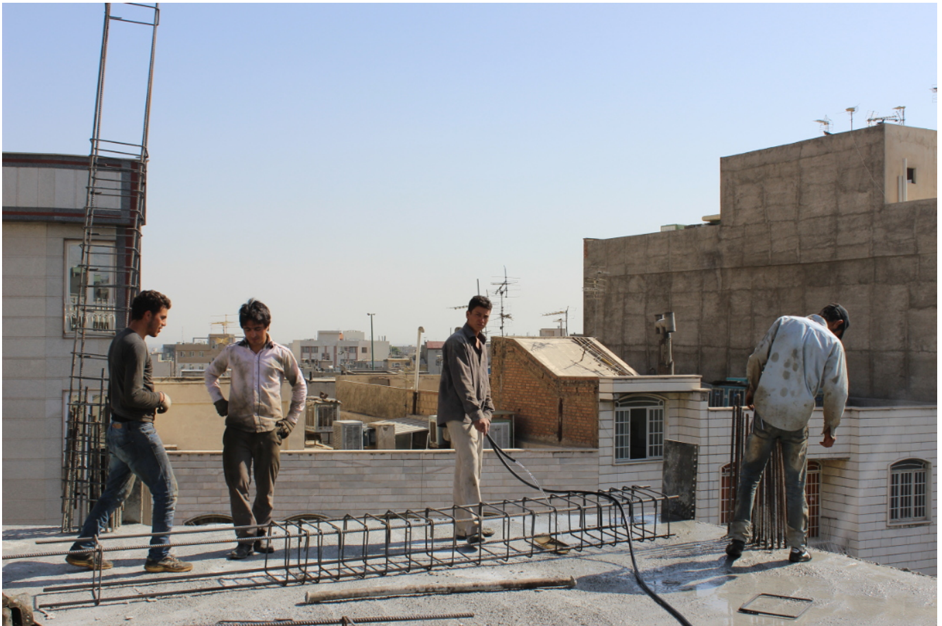
Afghanische Bauarbeiter auf einer Baustelle in Teheran. Foto: sharghzadeh , Afghan Construction Workers, Tehran Iran, CC BY-NC 2.0
